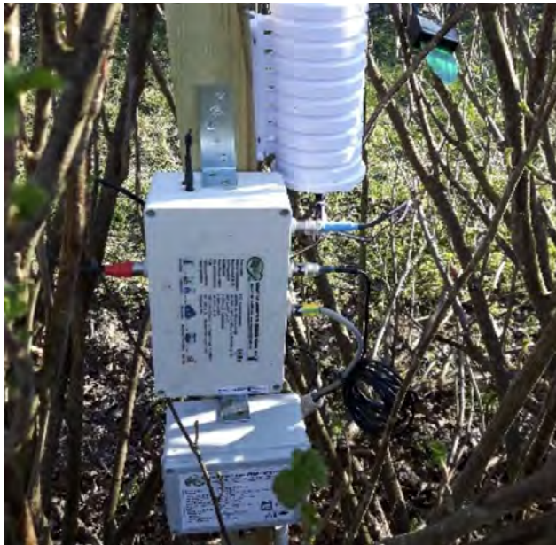
Foto: LoRaWAN-System mit Backup Logger-System am Standort Schöneiche
