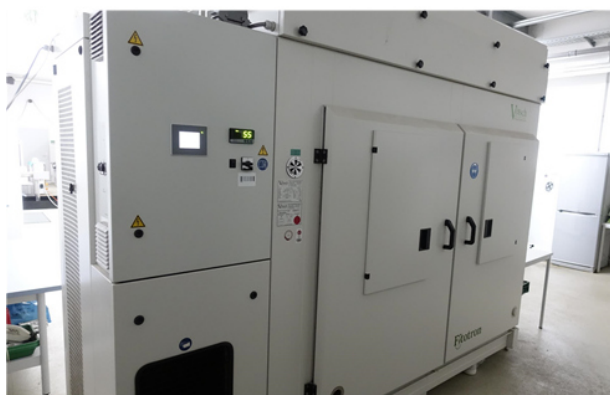
Abbildung 26: Pflanzenklimakammer zur Pflanzenanzucht (Fitotron HGC 1014 V; FA. Vötsch) – UV, Temperatur und Luftfeuchte
